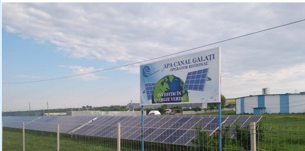
Panouri fotovoltaice Șerbești
