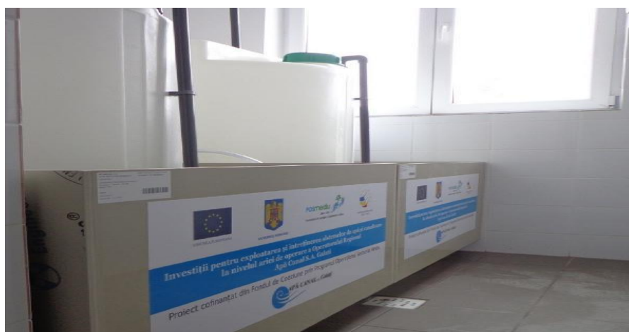
Instalație de hipoclorit de sodiu
