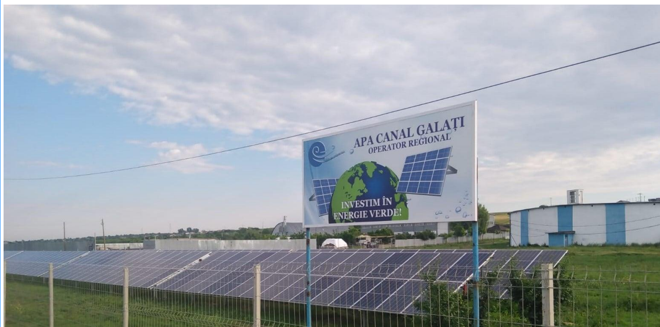
Panouri fotovoltaice Șerbești
